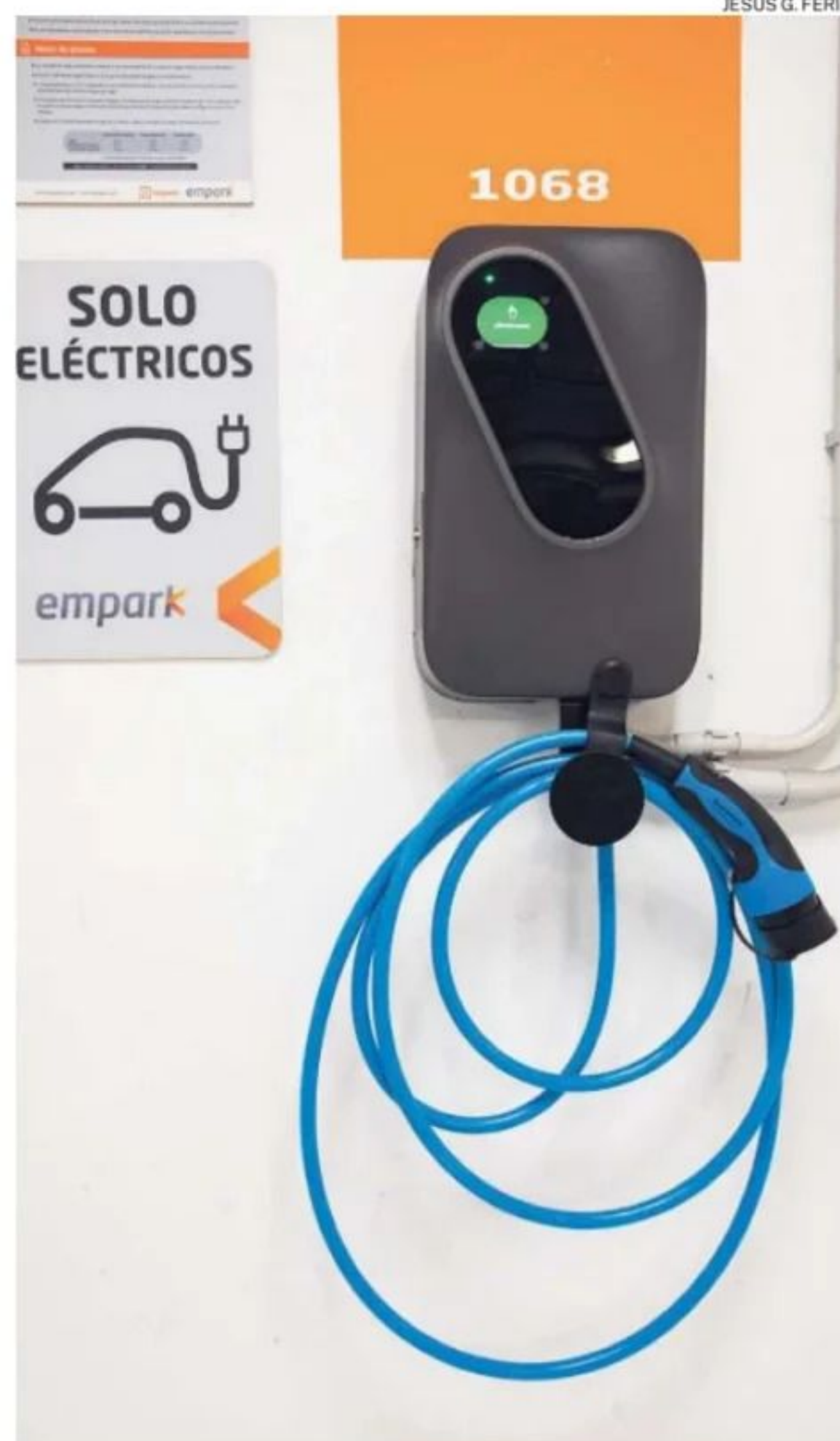
Punto de recarga para vehículos eléctricos
